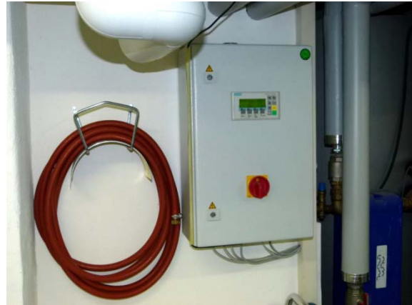
Abbildung 4 Steuerkasten mit Simatic S7 Bediengerät
